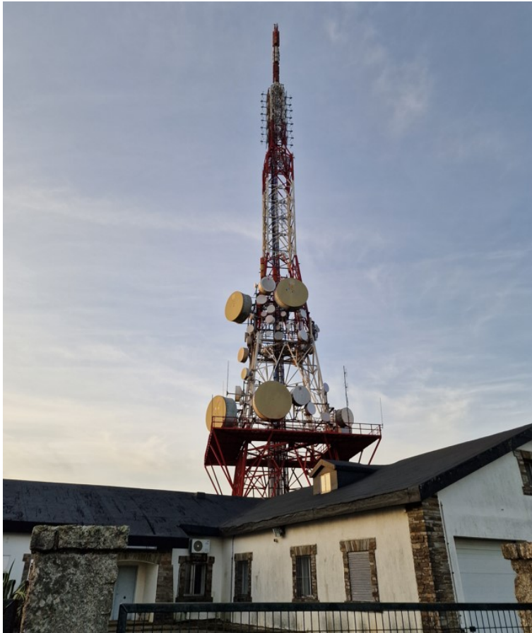
Figura 4: Torre de CELLNEX TELECOM en Pedroso
