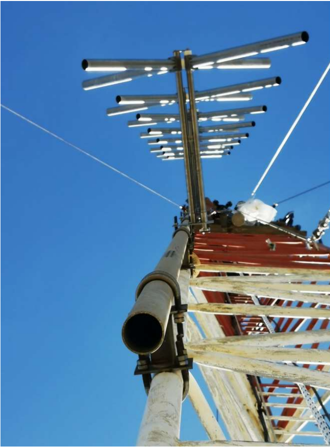
Figura 3: Sistema Radiante 8 QAD para CELLNEX, Camas (Sevilla)
